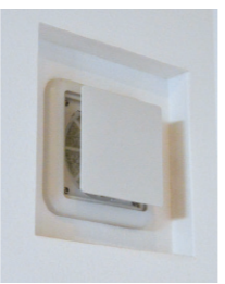
適切な換気を行う24時間換気システム
