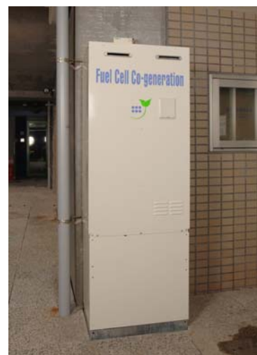
水素供給燃料電池コージェネレーション
